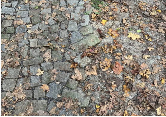
Dlažba s neexistujícím okrajem - roztroušení do trávy
